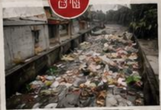
DRAINASE TIDAK BERFUNGSI
